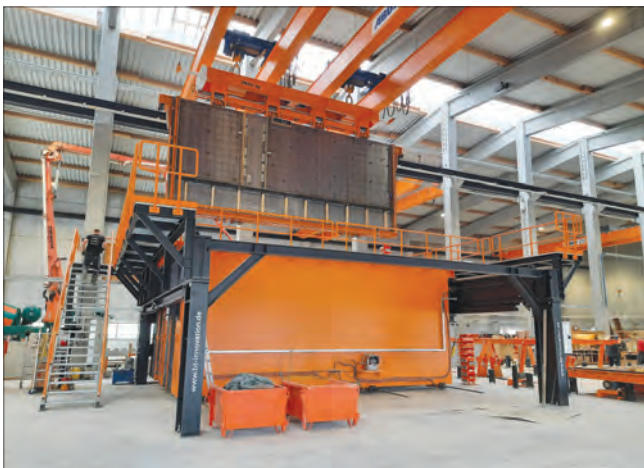
Установка опалубки «Бабочка» в кассетную установку Installation of the "Butterfly" formwork in a cassette unit
