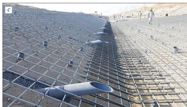
Рис. 7. Откосы канала, привязанные к плите дна с помощью специально изготовленных соединительных стержней: a – рабочий несет в руке пучок соединительных стержней; b – верхняя часть канала до укладки бетона, видны сетка, дренажные отверстия, опалубка; c – детализированный вид стыков внахлест на участке привязки откосов ко дну канала Fig. 7. The sloped sides of the JEC-FMC were tied to the base slab using bespoke splice bars: a – a worker carries a bundle of splice bars; b – prior to concrete placement, an overview of an upstream section of the JEC-FMC, showing grids, weep holes, and channel edge formwork; c – detail of lap splice at base-slope intersection
